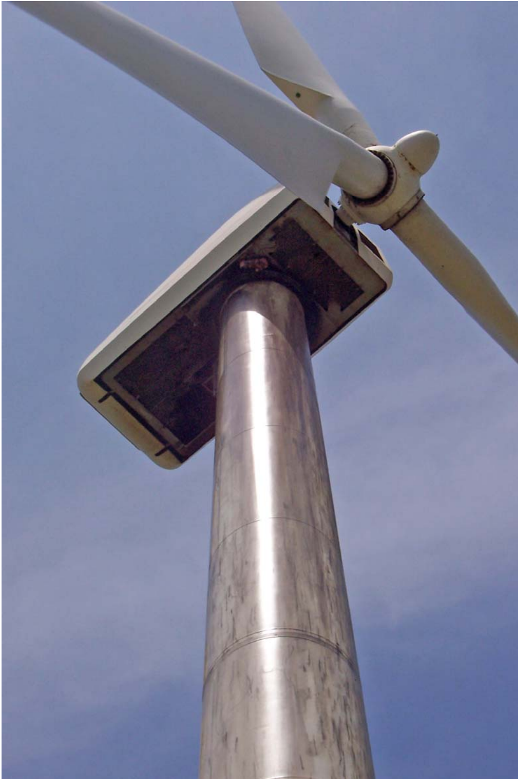
Detalle del mismo aerogenerador.
